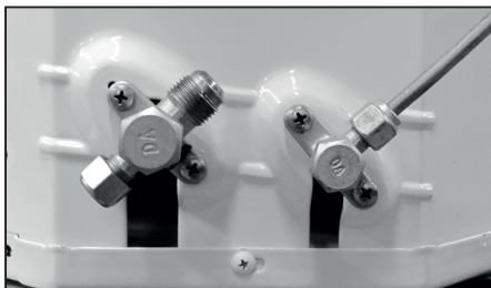
FIG. 41 - CONEXÃO DA LINHA DE EXPANSÃO DA UNIDADE CONDENSADORA
