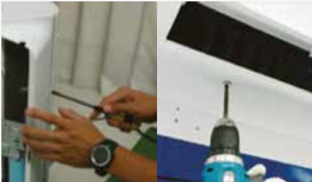
Ar condicionado de parede convencional
